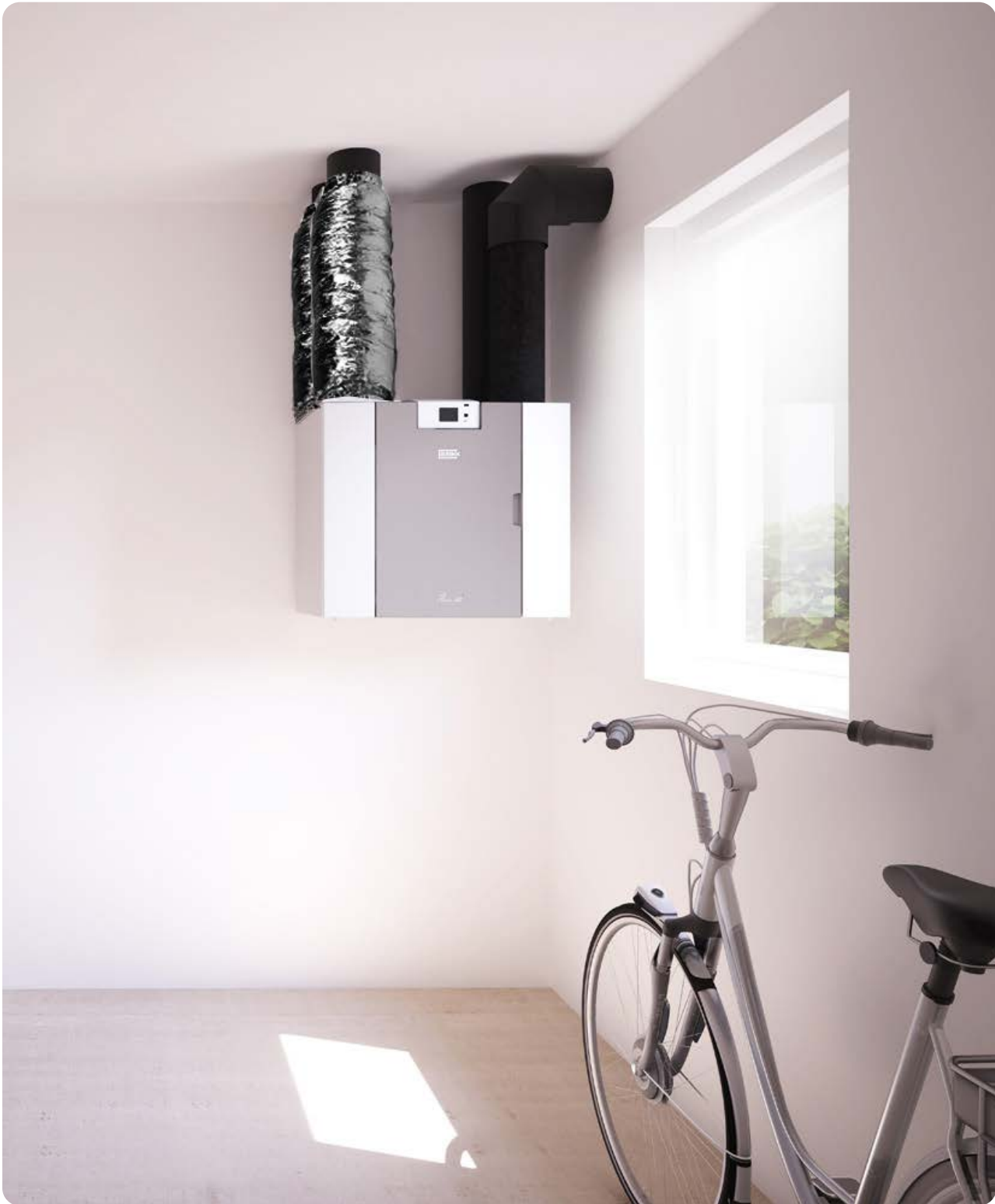
Unità Flair per l'impianto di Ventilazione Meccanica Controllata di un'abitazione con silenziatori posizionati sulle condotte di immissione e di estrazione aria dagli ambienti interni
