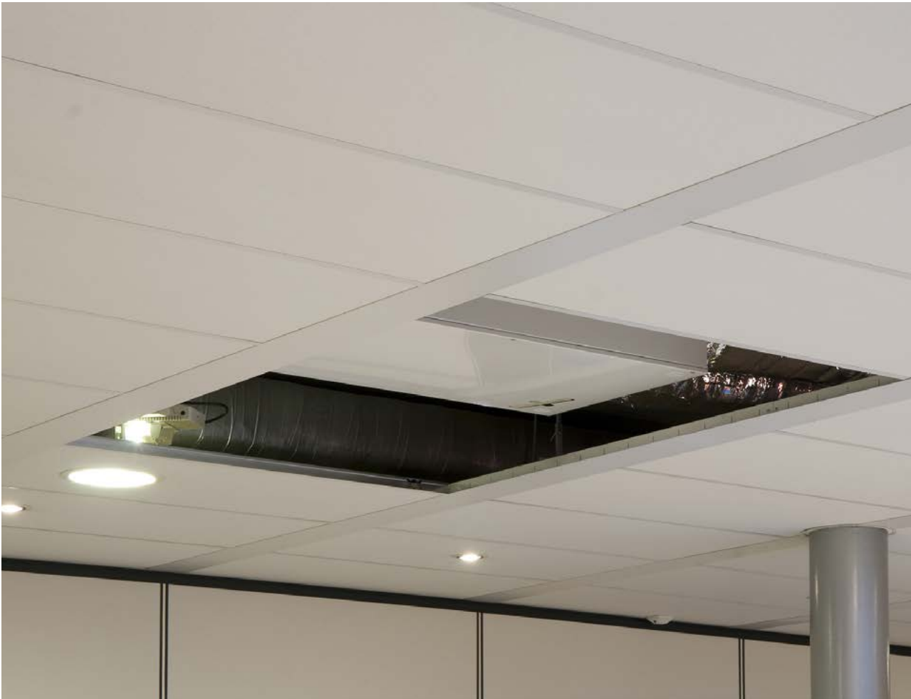
Unità della serie Renovent Sky per Ventilazione Meccanica Controllata installata a controsoffitto di un edificio adibito ad attività terziaria
