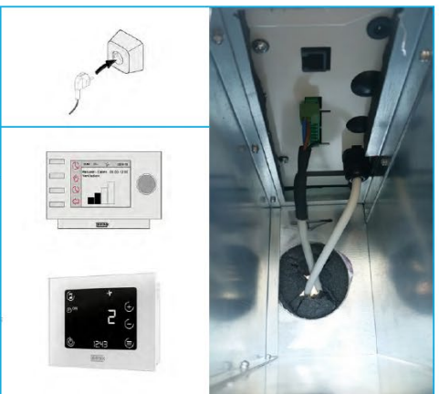
Presa da predisp./ Brink **Control / Vano cavi
